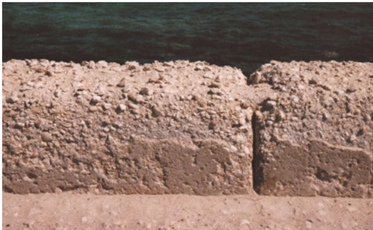
حوائط الكورنيش، ويظهر عليها التآكل والتدهور الشديد بسبب المناخ وأمواج البحر
